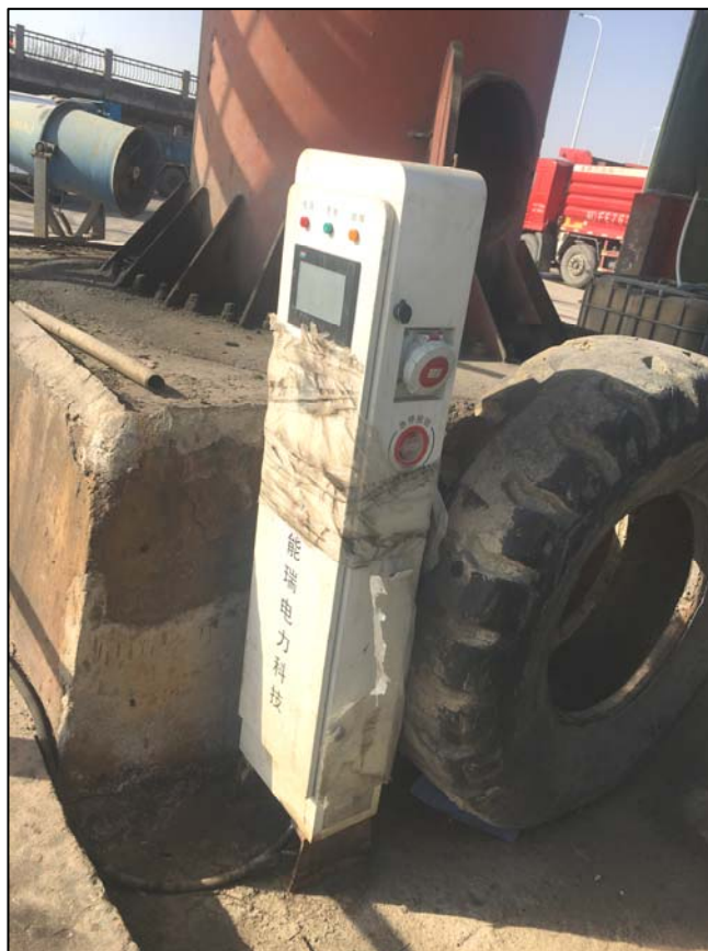
图 5.3-1 码头处已设置岸电设施
