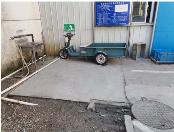
生产废水接管口及标识牌
