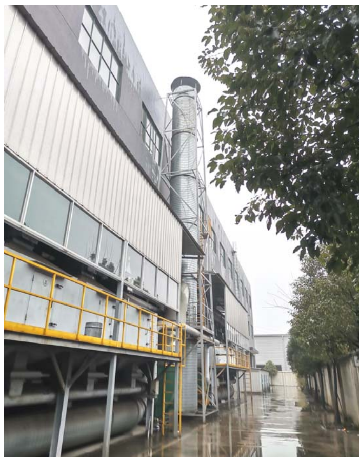
喷漆&晾干“干式过滤—活性炭吸附—解吸催化燃烧”装置、FQ-2#排气筒
